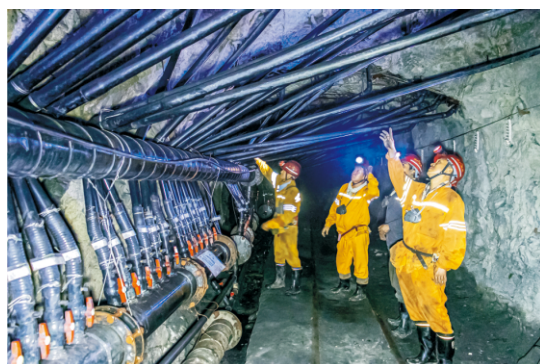
▲井下瓦斯抽放管道
